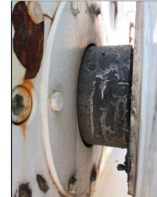
Massiver Lagerschaden des angetriebenen Laufwagen des Tores
